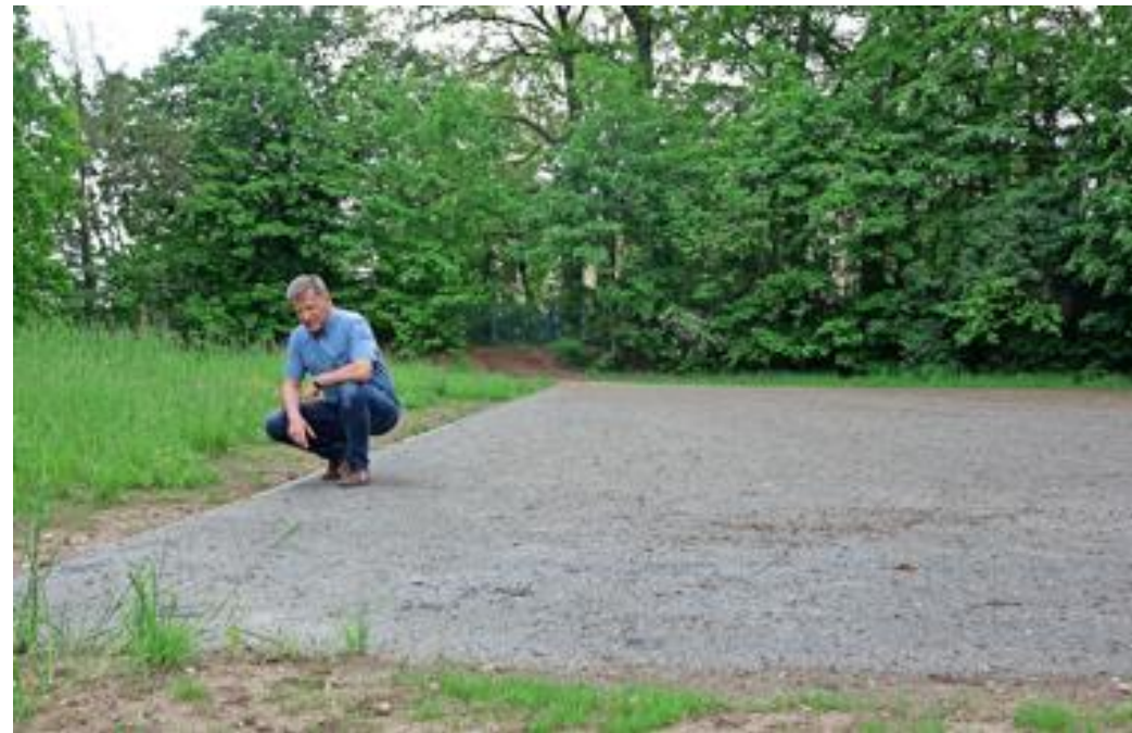
An der Robert-Härtwig-Straße in Oschatz können die Lehrerinnen und Lehrer nach der Erneuerung der Stellfläche jetzt wieder ordentlich parken.
